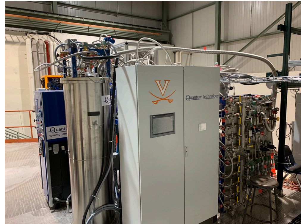
Helium Liquefier setup
